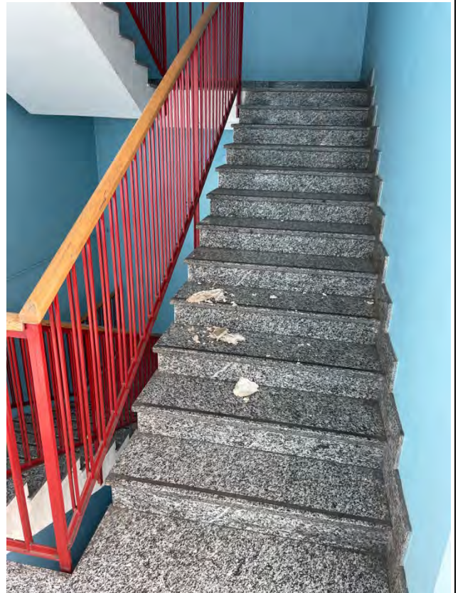
Residui di pannelli del controsoffitto deteriorato caduti sui gradini della scala
