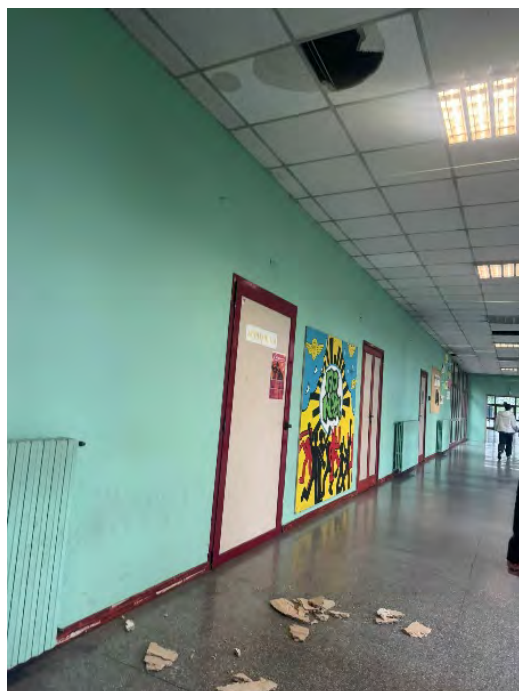
Infiltrazione d'acqua corridoio bar in corrispondenza dell'accesso all'Auditorium
