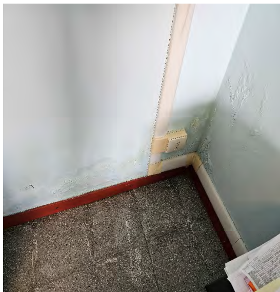
Formazione di muffa spigolo pareti perimetrali
