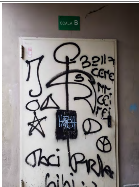
Serratura porta antincendio guasta
