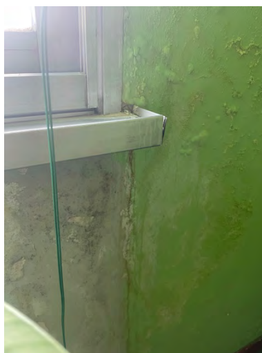
Formazione di muffa zona finestra
