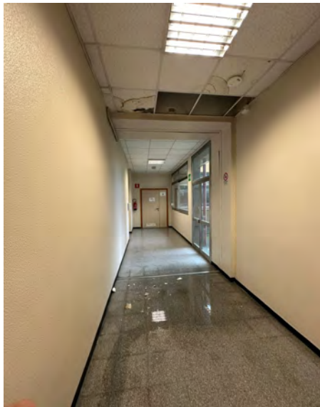
Infiltrazione d'acqua nel corridoio di accesso all'aula di disegno n.35
