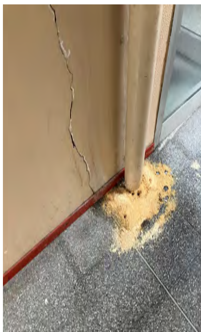
Infiltrazione di acqua – vista pavimento
