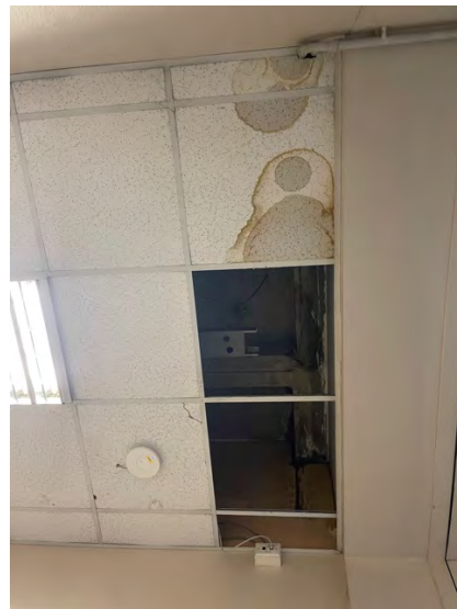
Infiltrazione d'acqua nel corridoio di accesso all'aula di disegno n.35 – vista dal basso
