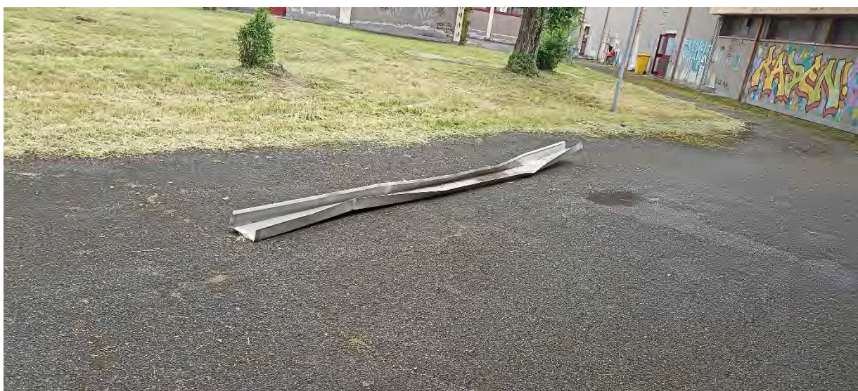
Scossalina metallica staccata dal supporto dal vento e caduta a terra.
