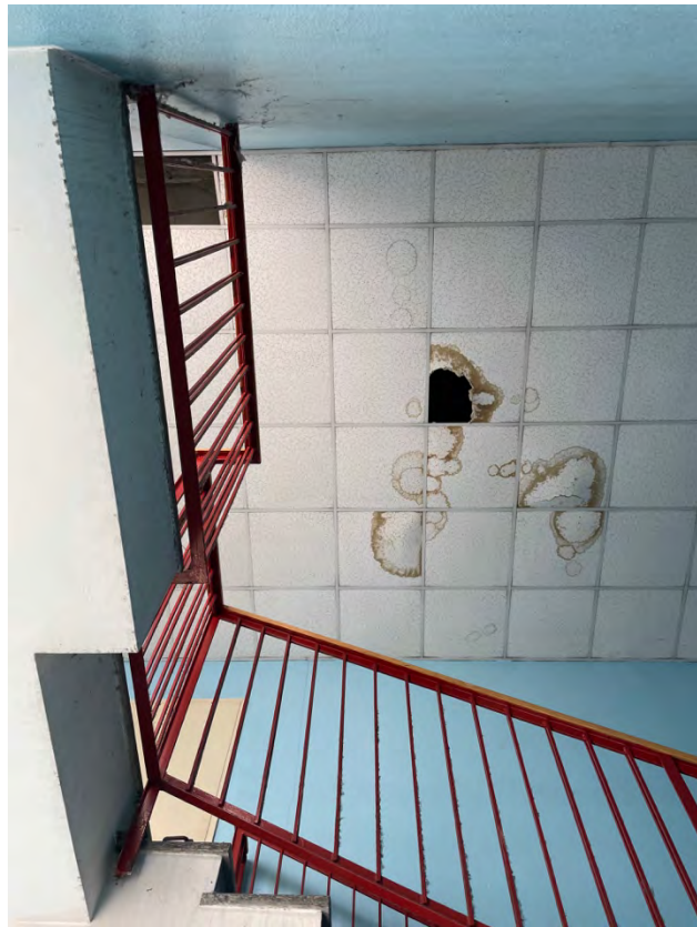
Infiltrazione d'acqua – vista dal basso
