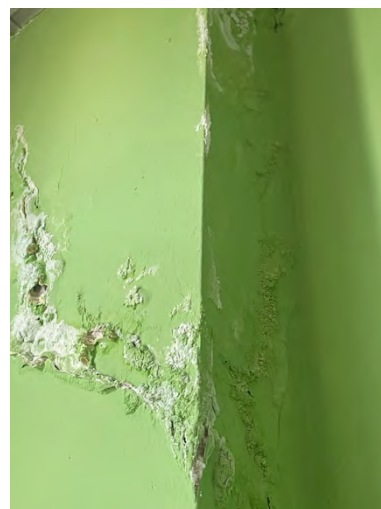
Distaccamento della finitura interna - superficie pilastro
