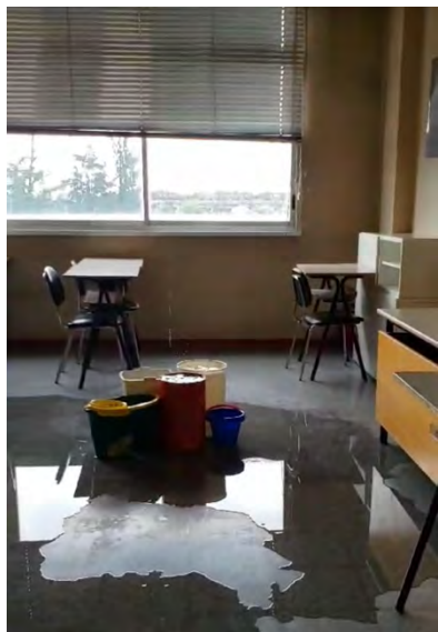
Infiltrazione d'acqua - lato cattedra
