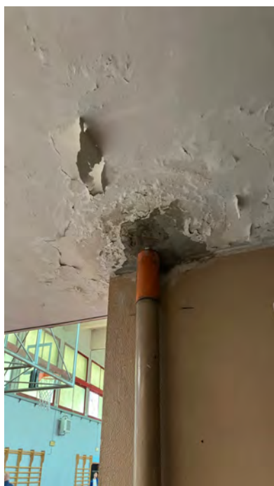
Infiltrazione di acqua – vista soffitto
