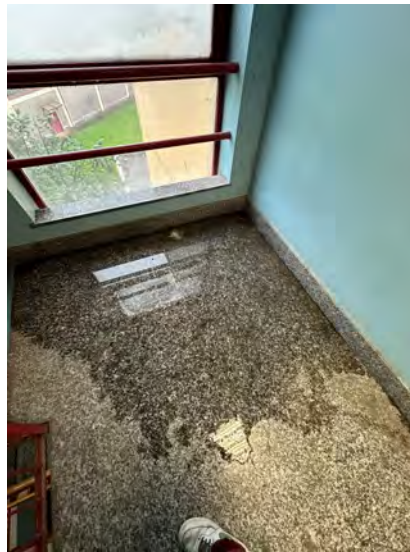
Infiltrazione d'acqua – vista dall'alto
