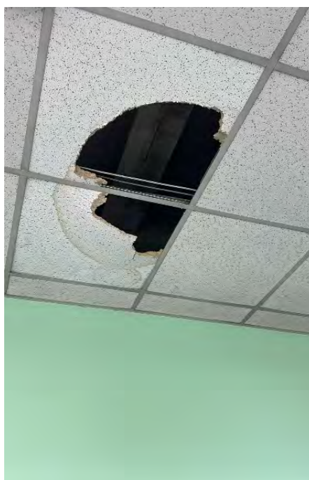
Infiltrazione d'acqua corridoio bar in corrispondenza dell'accesso all'Auditorium – vista dal basso
