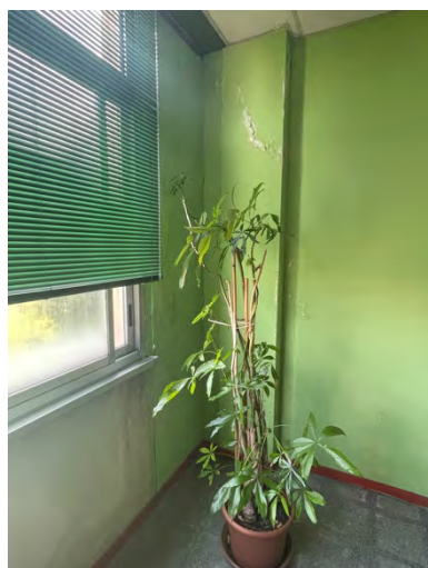
Infiltrazione acqua parete perimetrale presidenza
