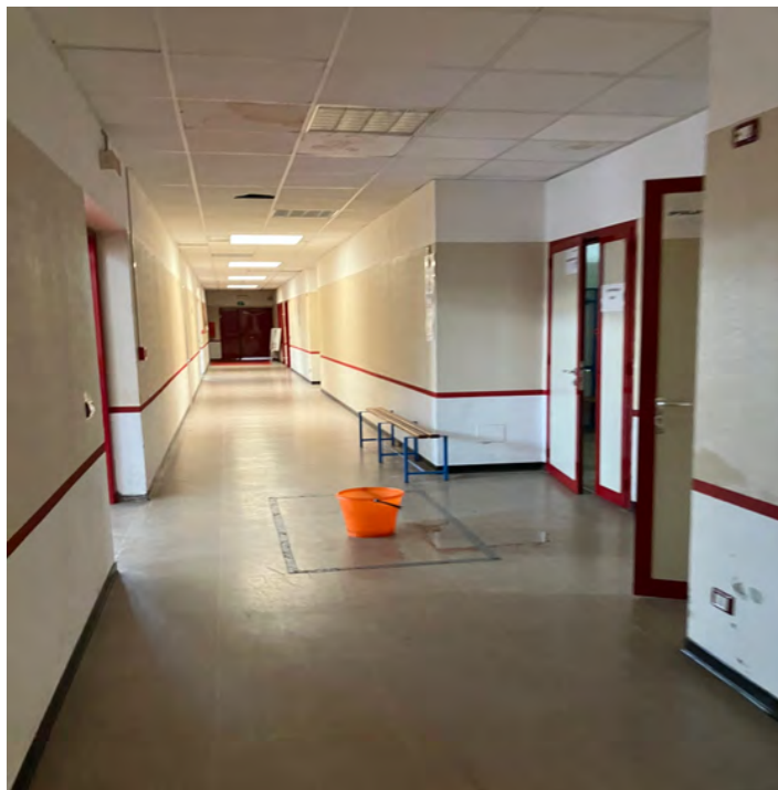
Infiltrazioni di acqua corridoio PalaEmotion
