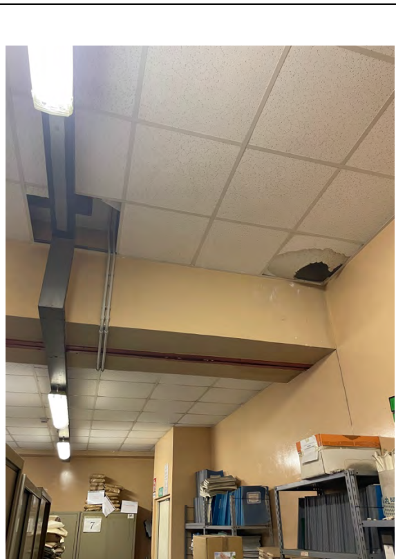
Infiltrazione d'acqua nell'archivio – vista controsoffitto
