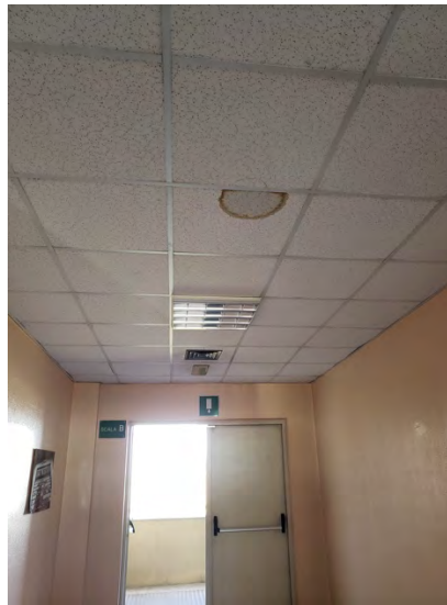
Serratura porta antincendio guasta
