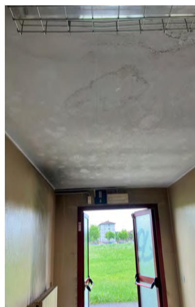
Infiltrazione di acqua
