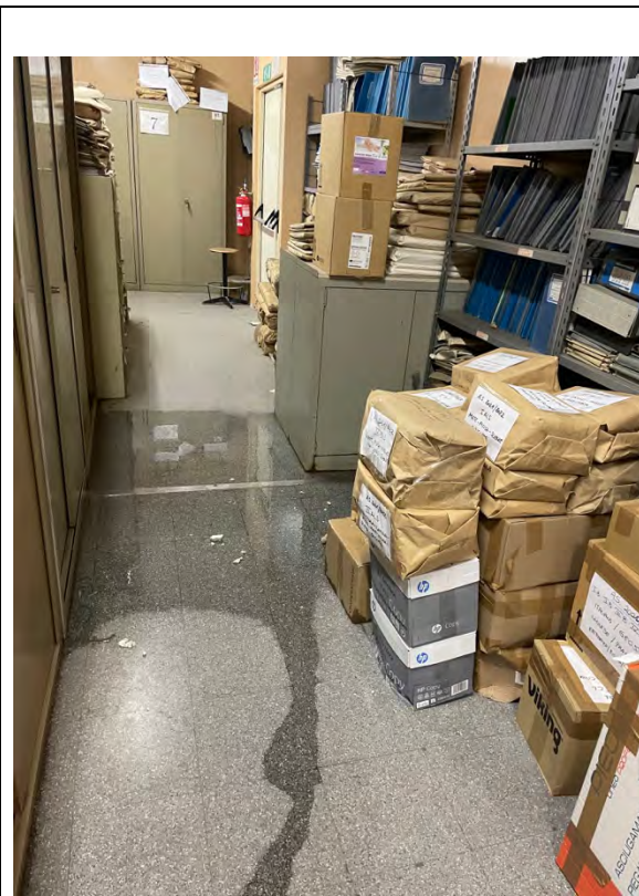
Infiltrazione d'acqua nell'archivio – vista pavimento
