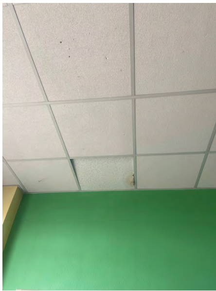
Pannello del controsoffitto deteriorato.
